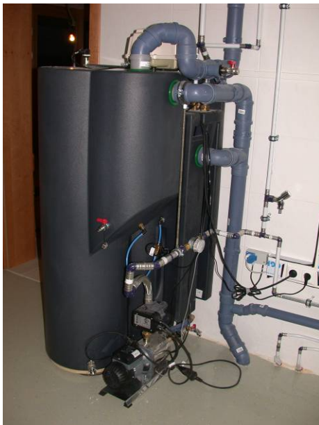
Abbildung 25: Verrohrung der Grauwasserreinigungsanlage Lieboch. Das oberste Rohr DN 110 mm ist das Zulaufrohr. Der Düker und die Probenentnahme sind gut zu sehen.
